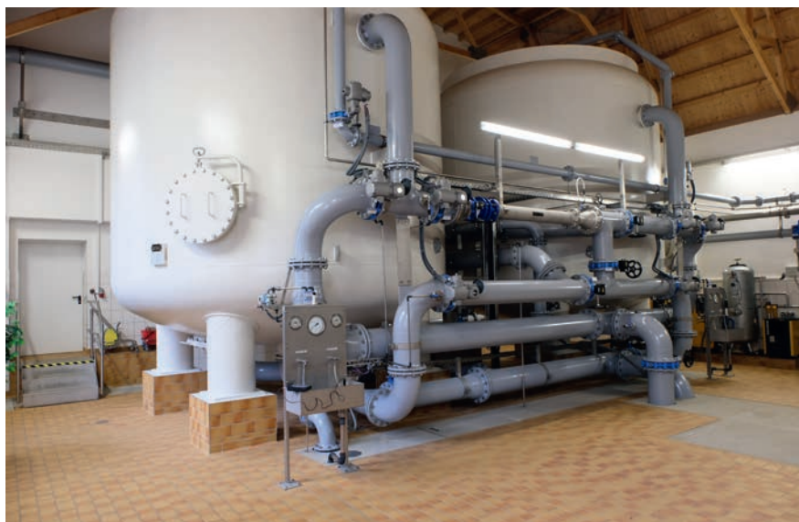
■ Große Maschinen, die viel Energie verbrauchen, sind im Wasserwerk und in der Kläranlage der Stadtwerke zu finden. Hier lohnen sich Energiesparmaßnahmen besonders.
