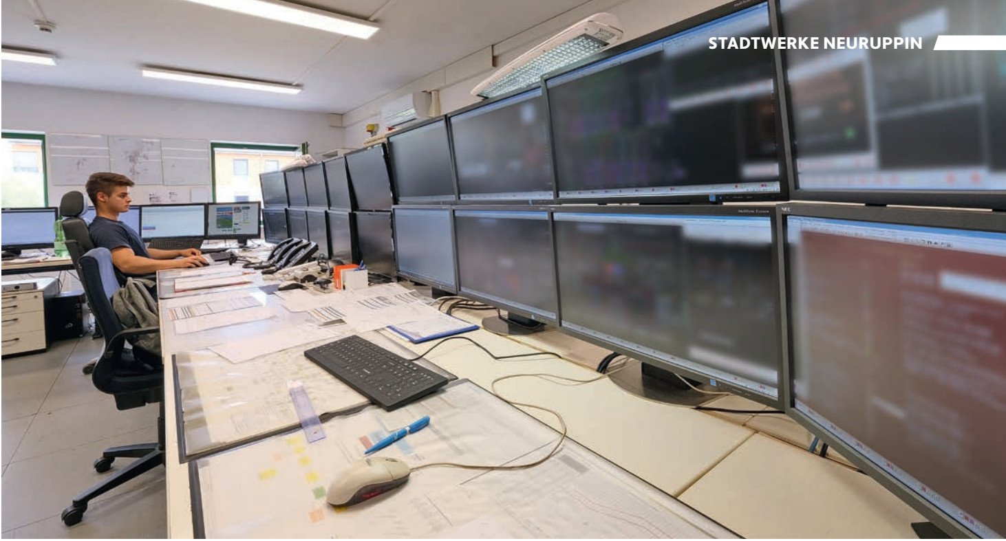
■ Schaltzentrale: In der Netzleitzentrale der Neuruppiner Stadtwerke wird rund um die Uhr für die Versorgungssicherheit Neuruppins gesorgt.
